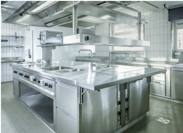
HAKA fertigte einen individuellen Kochblock für das Restaurant Bergstation Schauinsland in Freiburg / Foto: HAKA
