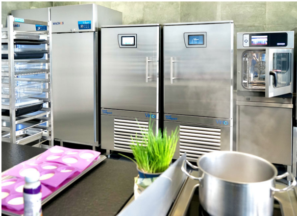
Schnellkühler, die nach DIN 10536 die Speisen herunterkühlen, garantieren den perfekten Einstieg in die zeitversetzte Speisenproduktion / Foto: Netzwerk Culinaria
